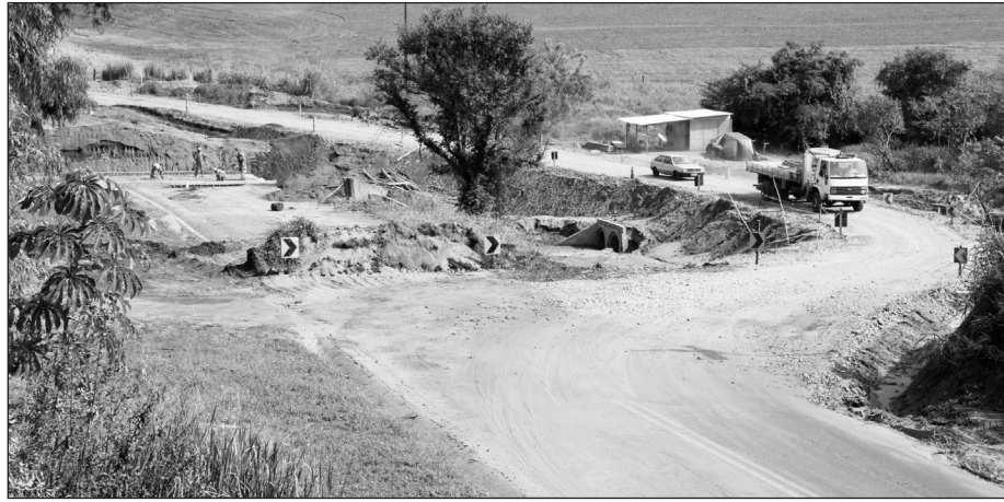
Os trabalhos na altura do km 50+500 na rodovia da PR-542 no trecho da Água Grande trata-se de um Bueiro Duplo Celular em Concreto numa extensão de 19 metros o valor desta obra, está orçado em 685 mil reais
