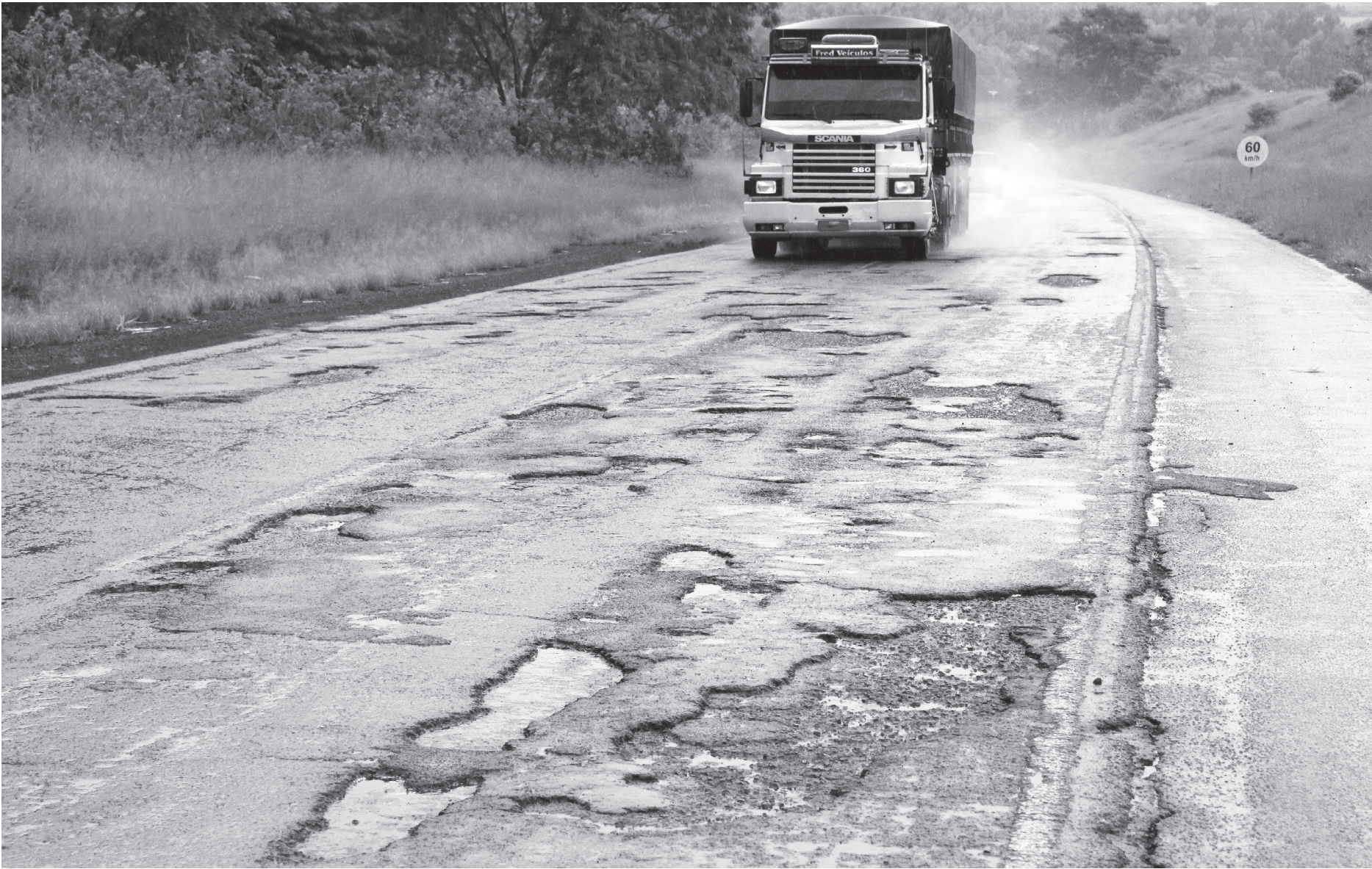
A péssima conservação de estradas é um problema crônico na região. E não é só questão de infraestrutura, mas de segurança no trânsito. Os acidentes têm provocado lesões graves (muitas vezes irreversíveis) e ceifado a vida de milhares de pessoas. Os danos têm várias causas: buracos no asfalto, ausência de sinalização, inexistência de acostamentos, só para citar alguns exemplos
