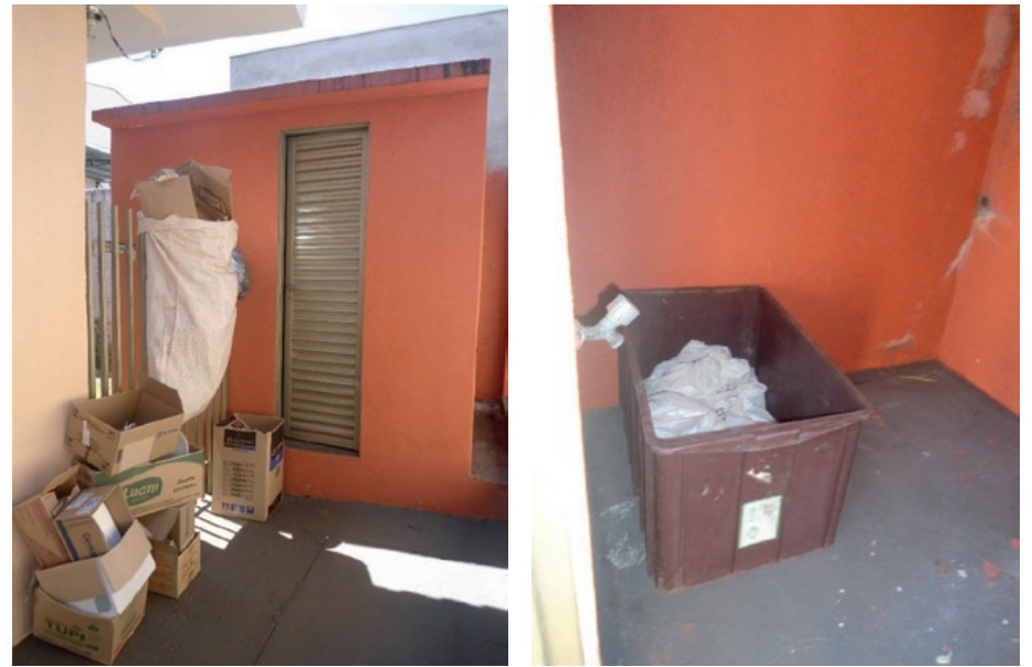
Figura 3.32 - Depósitos de resíduos de saúde do Posto de Saúde Jardim das Flores
