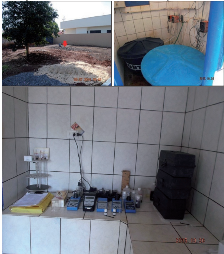
Figura 3.12 - Reservatório de 650m³ e sala de desinfecção/laboratório.
