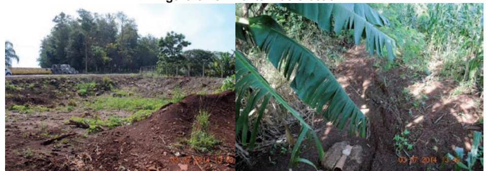
Figura 3.48 - Ponto 1 de erosão
