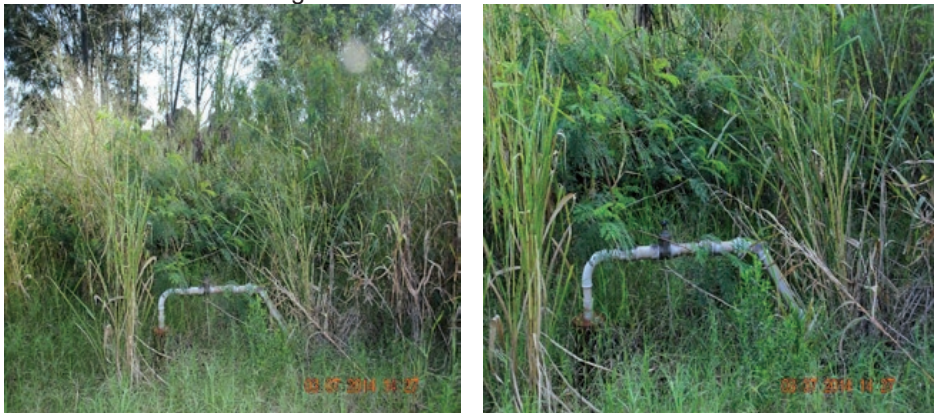
Figura 3.3 – Registro fotográfico dos poços de captação de água de São Jorge do Ivaí – abastecimento da área urbana
