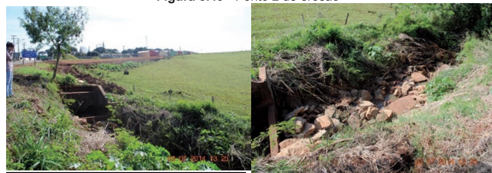
Figura 3.49 - Ponto 2 de erosão
